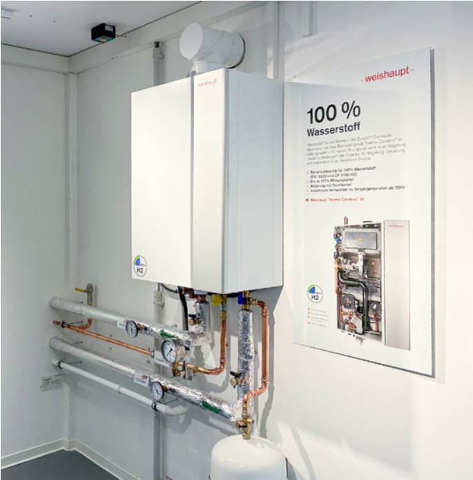
Foto: Weishaupt; Quelle: Gas- und Wasserstoffwirtschaft
